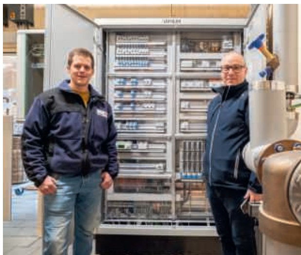
Fabio Rüegger et Tom Haller, de StWZ Energie AG, devant le nouveau répartiteur principal du centre de jardinage.
